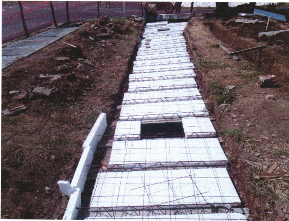
Foto 11 - FABRICAÇÃO, MONTAGEM E DESMONTAGEM DE FORMA PARA RADIER, PISO DE CONCRETO OU LAJE SOBRE SOLO, EM MADEIRA SERRADA, 4 UTILIZAÇÕES. AF_09/2021
