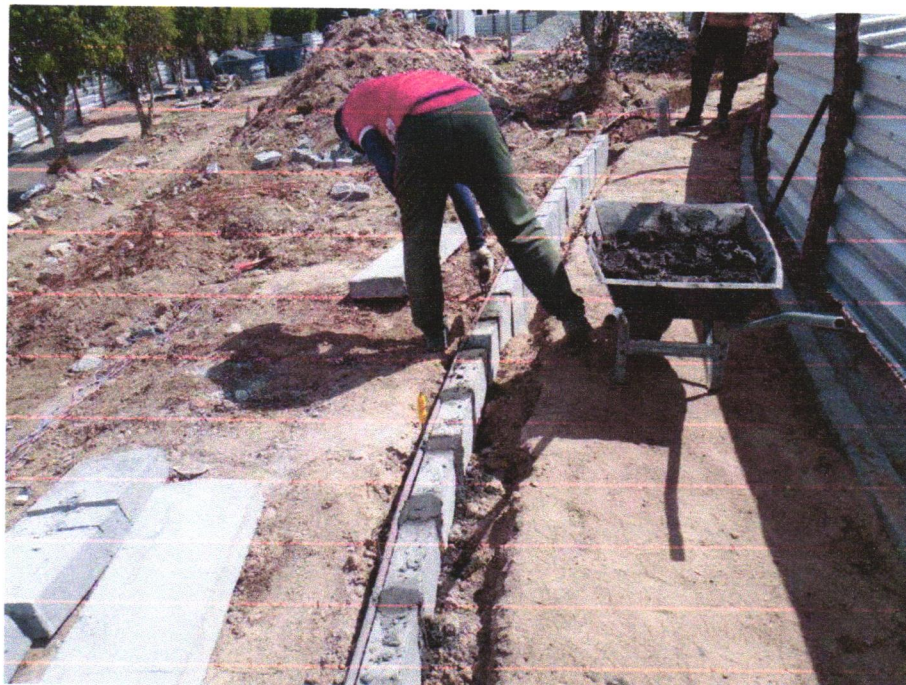
Foto 04 - ASSENTAMENTO DE GUIA (MEIO-FIO) EM TRECHO CURVO, CONFECCIONADA EM CONCRETO PRÉ-FABRICADO, DIMENSÕES 100X15X13X20 CM (COMPRIMENTO X BASE INFERIOR X BASE SUPERIOR X ALTURA), PARA URBANIZAÇÃO INTERNA DE EMPREENDIMENTOS. AF_06/2016_P
